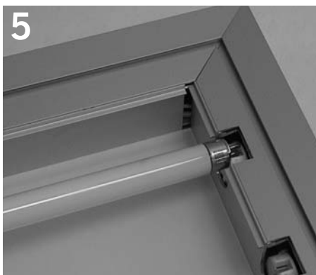
Install lamps per relamp label.
